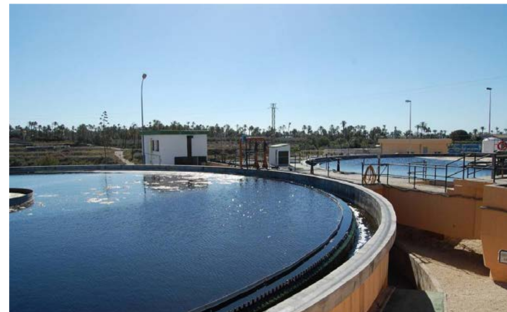
Estación depuradora de aguas residuales de Monte Orgegia
