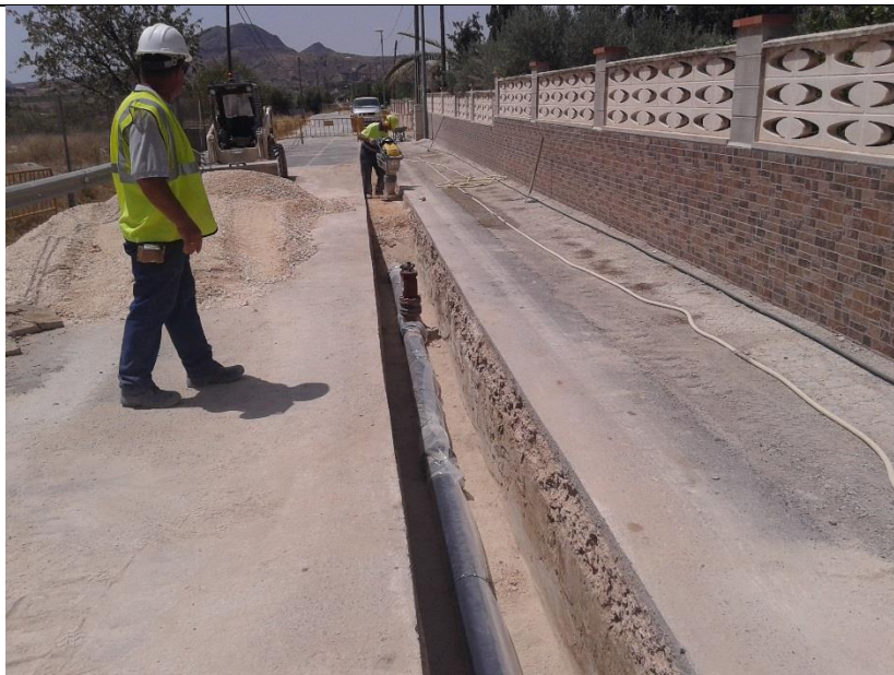
Foto 12: Canalización agua potable La Alcoraya.
